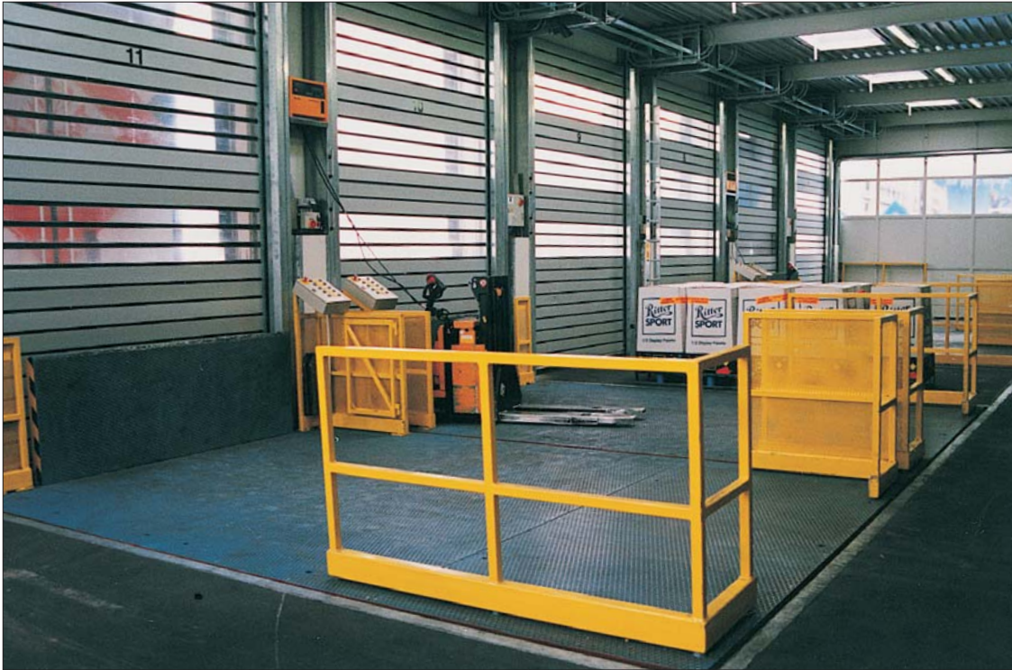
ARNOLD Hubtisch-Anlage vorbereitet zur Materialbeschickung.
